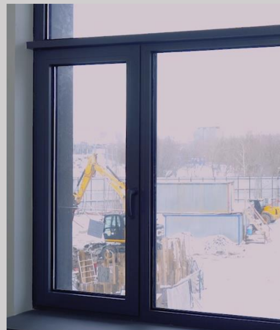
До установки проветривателя
